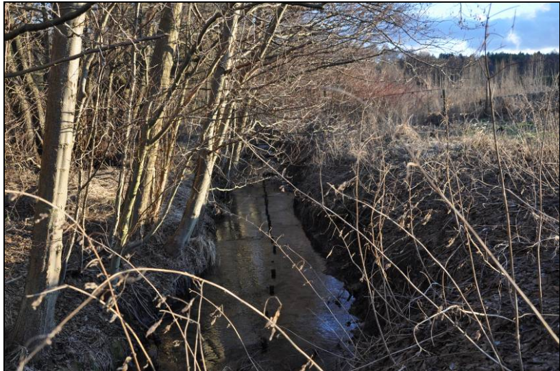
Abbildung 39: Abschnitt des Schurkengrabens mit verfallenem Uferverbau und freier Uferentwicklung bei Stat. km 00+700 (Foto: F. Tugendheim, 04.03.2010)
