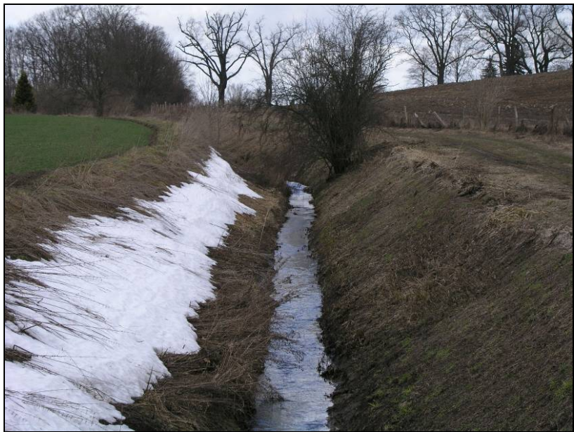
Abbildung 36: Eingetiefter Abschnitt der Lechnitz mit gegenüber dem Referenzzustand stark verändertem Ufer bei Stat. km 05+500 (Foto: M. Dembeck, 03.03.2010)
