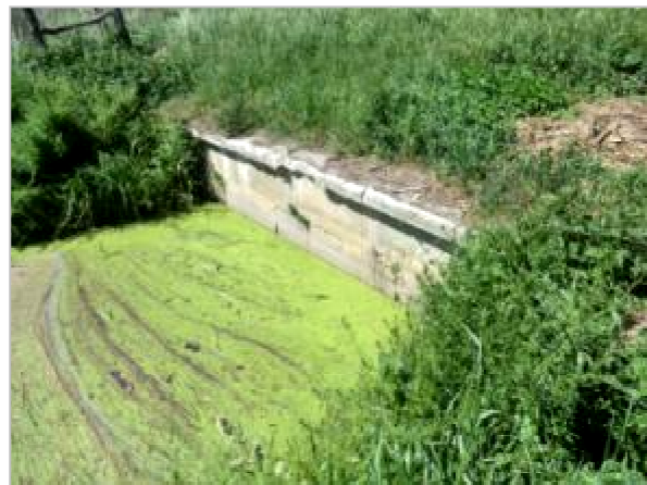
Abbildung 5-13: überstauter Plattendurchlass im Rhingraben
