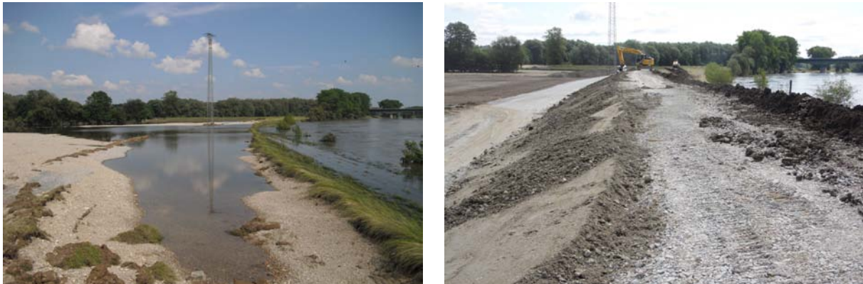
Abb. 4-5: Deichbruch Auterwörth, Bruchstelle und Schadensbeseitigung nach dem Hochwasser 2013
