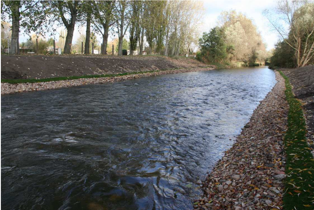
Abb. 13: Stauanlage der ehemaligen Zuckerfabrik an der Jeetze in Salzwedel – nach Abschluss der Maßnahme
