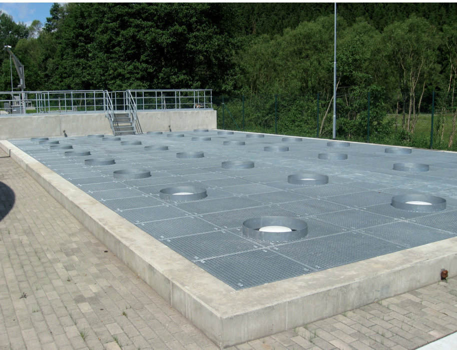
Kläranlage Suhl - Ansicht der Filtration
