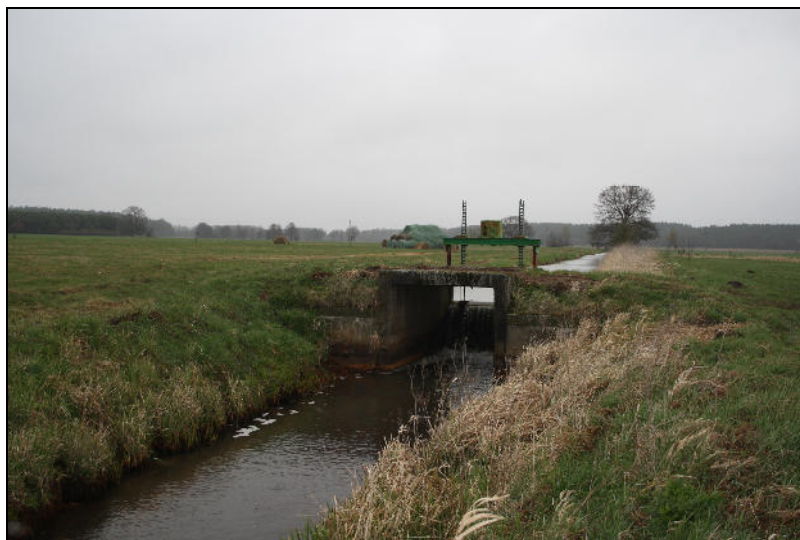
Abbildung 76: Nicht durchgängiger Fließgewässerabschnitt der Karthane bei km stat. 41+200 mit einem hohen Absturz durch die Stauhaltung (Foto: FuK, 07.04.2012)
