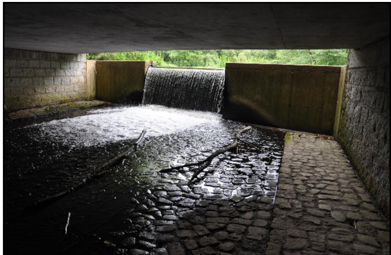
Abbildung 83: Wanderhindernis und Sedimentfalle am Cederbach in Hoppenrade, km stat. 13+900 (Foto: FPB GmbH, 06.06.2012)
