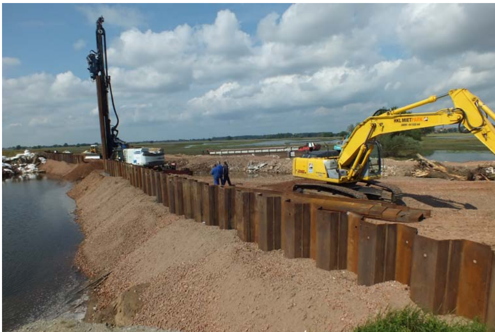
Abbildung 4.5: Wiederherstellung der Deichsicherheit am Deichbruch an der Elbe bei Fischbeck (Quelle: LHW)
