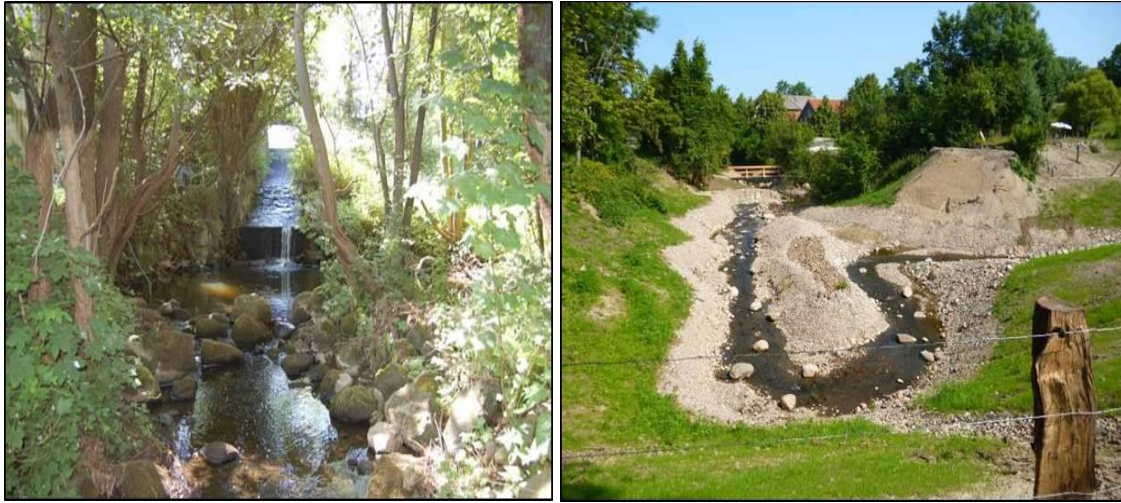
Abb. 73: Bau eines Umgehungsgerinnes in der Mühlenau (ko_02) bei Futterkamp (links: vorher, rechts: Bauphase)
