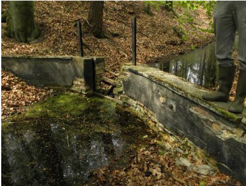
Abbildung 4: defektes Staubauwerk aus Klinkermauerwerk mit Betonplattenabdeckung und Staubohlen im Glasowgraben
