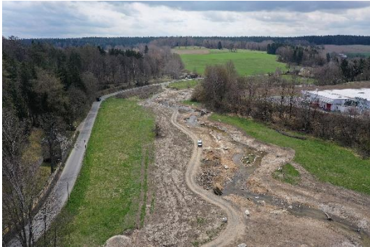
Foto 23: Laufveränderungen durch bauliche Maßnahmen sind mit umfangreichem Material und Technikeinsatz verbunden und erfordern eine ausreichende Flächenverfügbarkeit. (Foto: STOWASSERPLAN)
