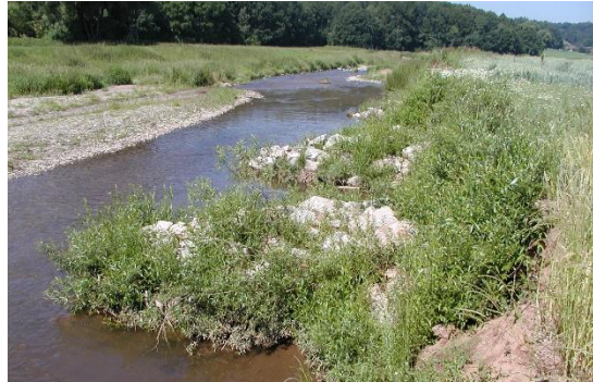
Foto 30: Begrünte Blockbuhne, Buhne aus gesetzten und geschütteten Lagen Wasserbausteinen mit einer Begrünung aus Buschlagen. Steinbuhnen bewirken auf Grund ihrer Massivität deutliche Veränderungen in der Strömung. Je nach Ausrichtung der Buhne (inklinant oder deklinant) werden Erosionen am Ufer und Kolkbildungen in der Gewässersohle ausgelöst. (Foto: STOWASSERPLAN)
