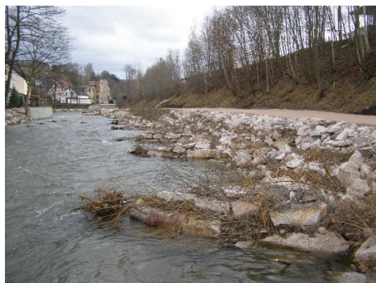
Foto 14: Auch eine Abfolge von Bühnen kann zur Strömungs- und Substratvielfalt beitragen. Wichtig ist dabei wiederum die Begrünung, da auch das Astwerk für Strukturvielfalt sorgt. (Foto: STOWASSERPLAN)
