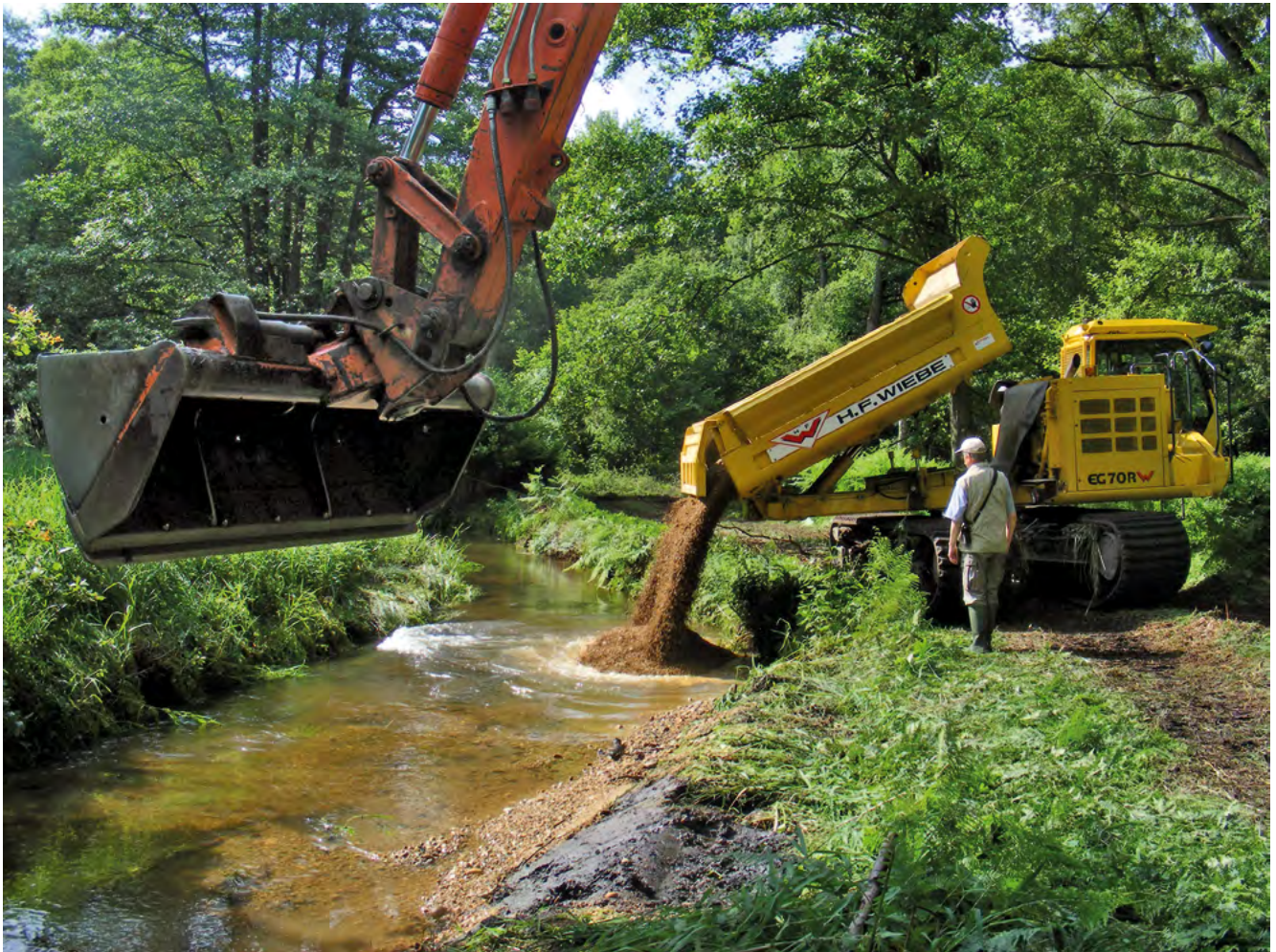
Ein „Klassiker“ der Maßnahmenumsetzung: Der Einbau von gewässertypischem Kies zur Verbesserung von Sohlenstrukturen unserer Fließgewässer hat sich bewährt, klingt einfach, erfordert aber Sach- und Fachverstand. (Foto: Jens Kubitzki)
