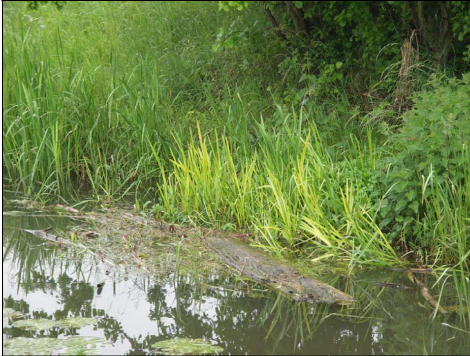
Abb. 34: Fischpass Grafhorst: Einstieg aus dem Oberwasser zugewachsen und mit Treibgut verstopft (im Rückstaubereich, Aufstau; 03.06.2006)
