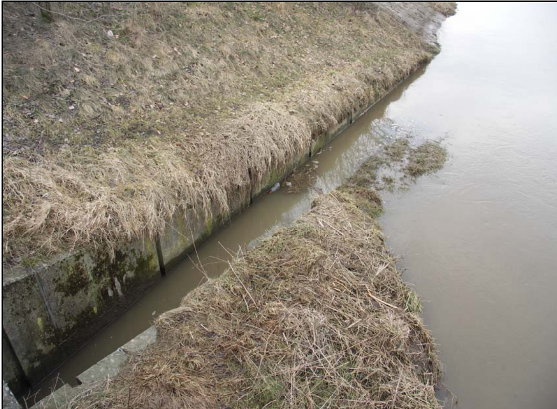
Abb. 32: Fischpass Grafhorst: Einstieg aus dem Unterwasser auf Grund fehlender Anströmung nicht möglich (21.03.2006)
