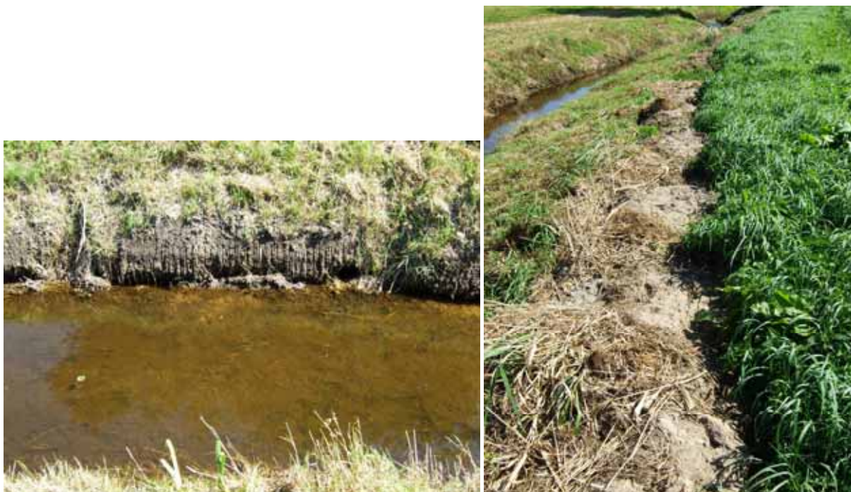
Abb. 61 u. Abb. 62: Vergleichsstrecke ohne Maßnahmen nach Mähkorb-Unterhaltung, August 2009, Uferschaden und geräumtes Sediment
