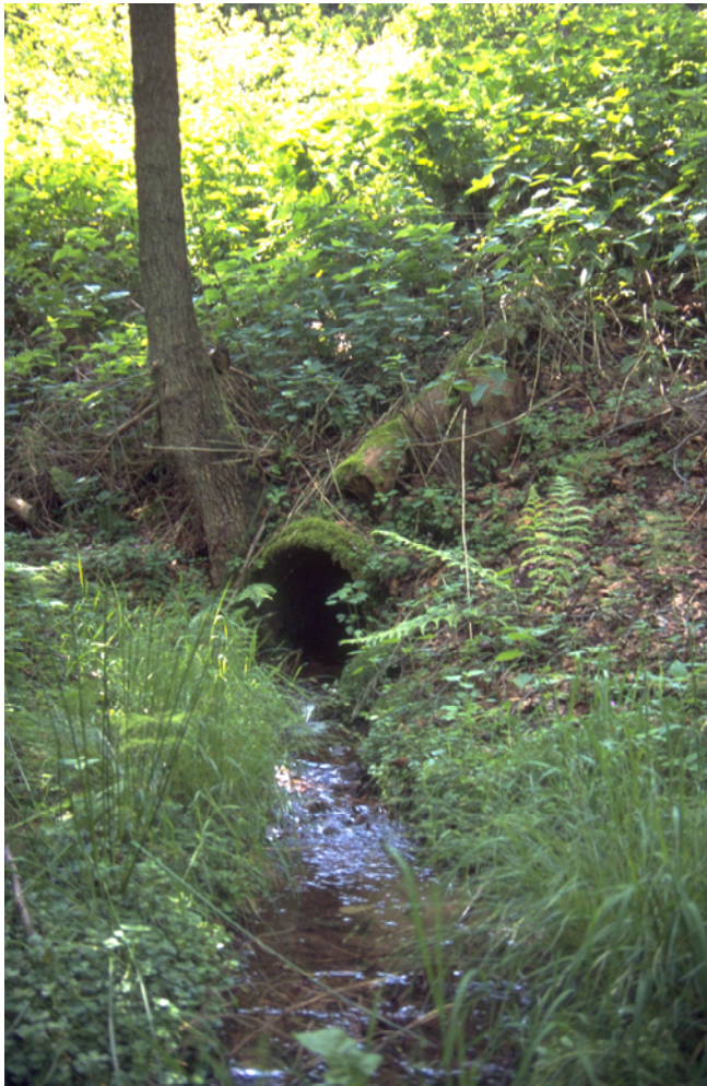
Foto 2: Rohrdurchlass mit Absturz unter einem Wirtschaftsweg im Waldgebiet des Elfes
