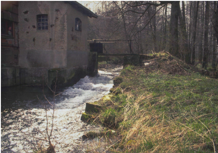
Foto 4: Wehranlage mit hohem Absturz ohne Wasserableitung. Ohne Funktion
