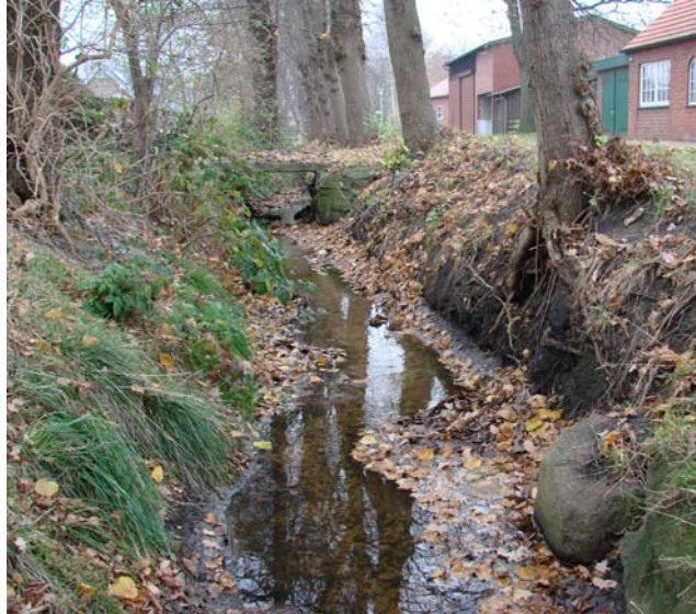
Abbildung 26: Freigespülte Baumwurzel an der Schmoo in Hepstedt (km 12+600)
