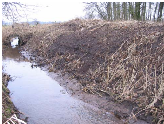
Abbildung 34: Erosionsanfällige Böschung am Mühlenbrooksbach (km 1+800)
