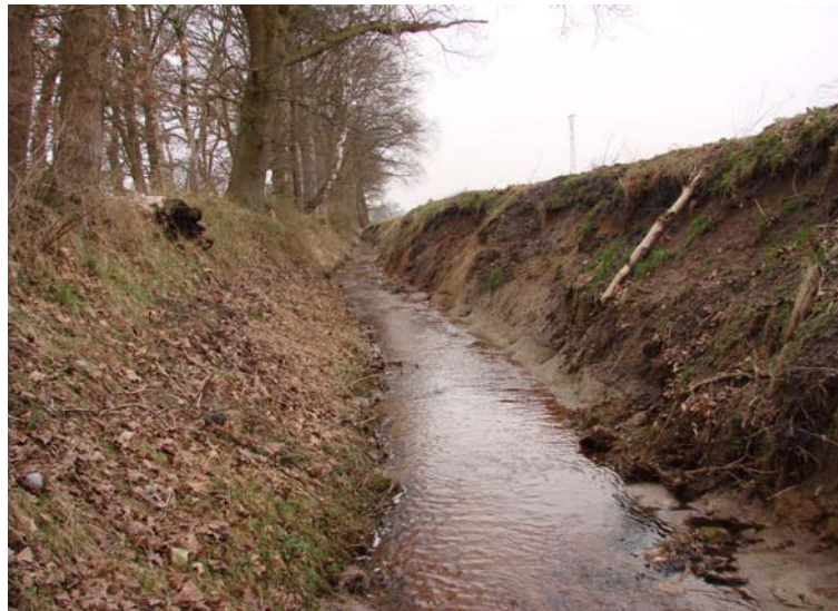
Abbildung 19: Abbruchkanten am Reithbach, Blick in Fließrichtung (km 7+100)
